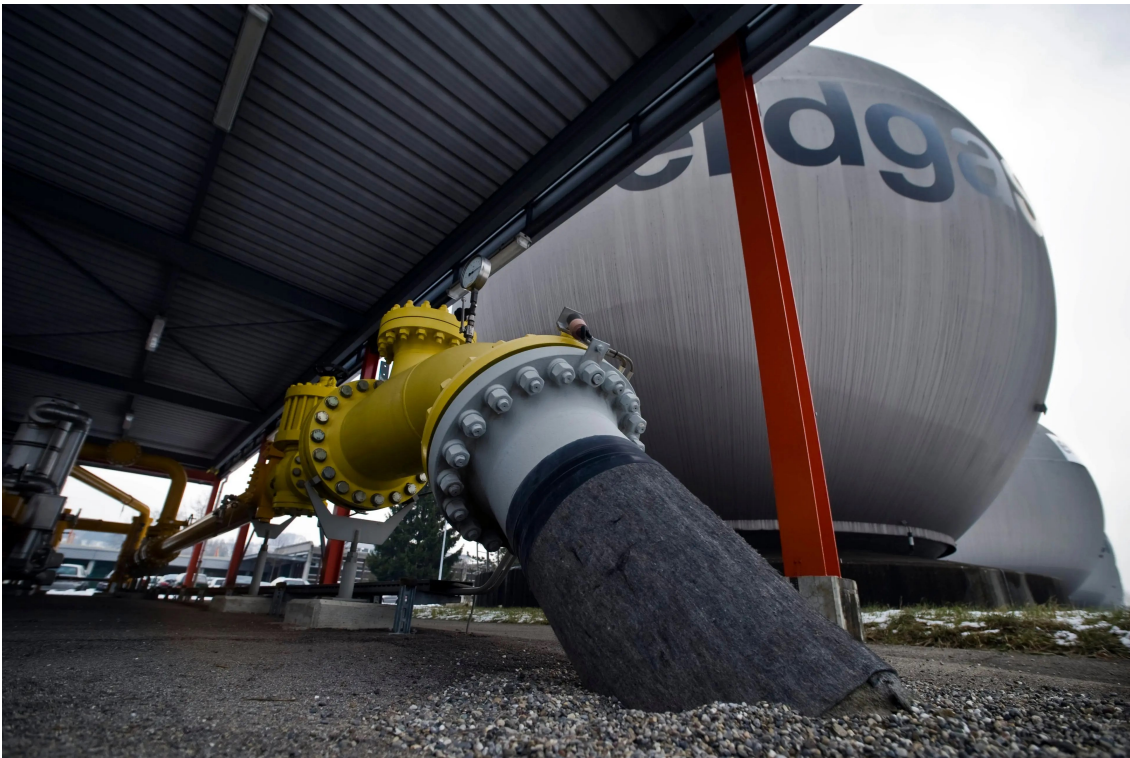
Druckreduzier- und Messstation der Erdgas Ostschweiz AG mit den Kugelspeichern, die zur Regulierung des Tagesbedarfes verwendet werden. Symbolbild: Urs Jaudas/Keystone
